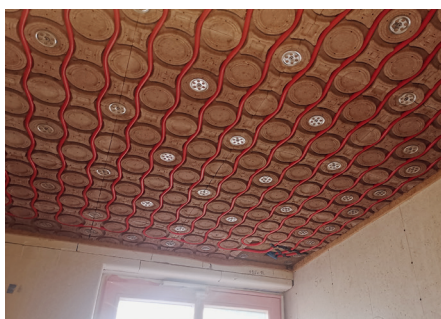
Wasserführende Schlauchleitungen in den Lehmmodule heizen und kühlen von oben.
