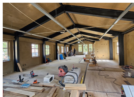
Die Saaldecke stellte bei der Planung der Heiz- und Kühlflächen eine besondere Herausforderung dar. Bild: Gemeinde Schorfheide
